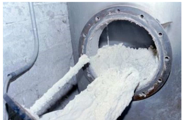
Nicht gewarteter Boiler mit starker Verkalkung
